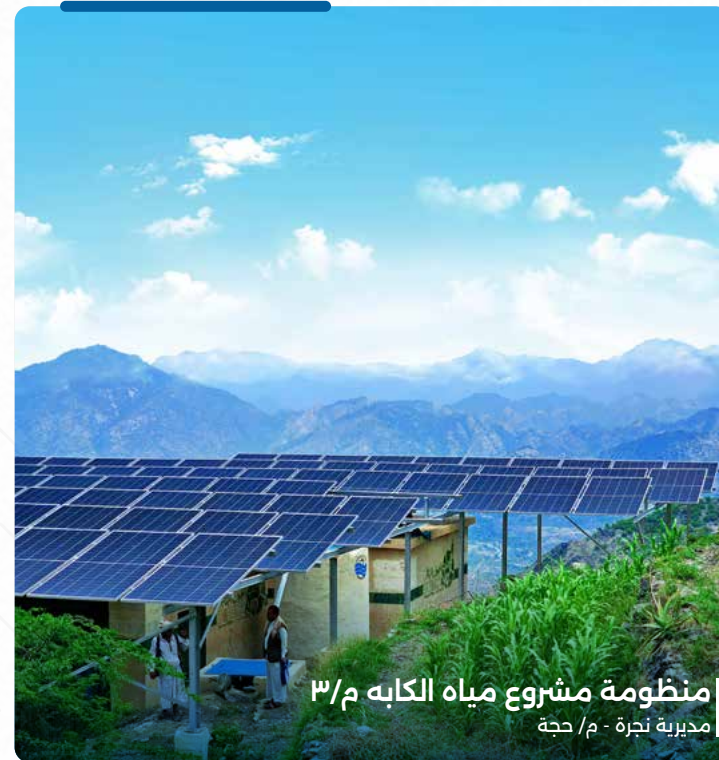
منظومة مشروع مياه الكابه م/٤ مديرية نجرة - م / حجة
